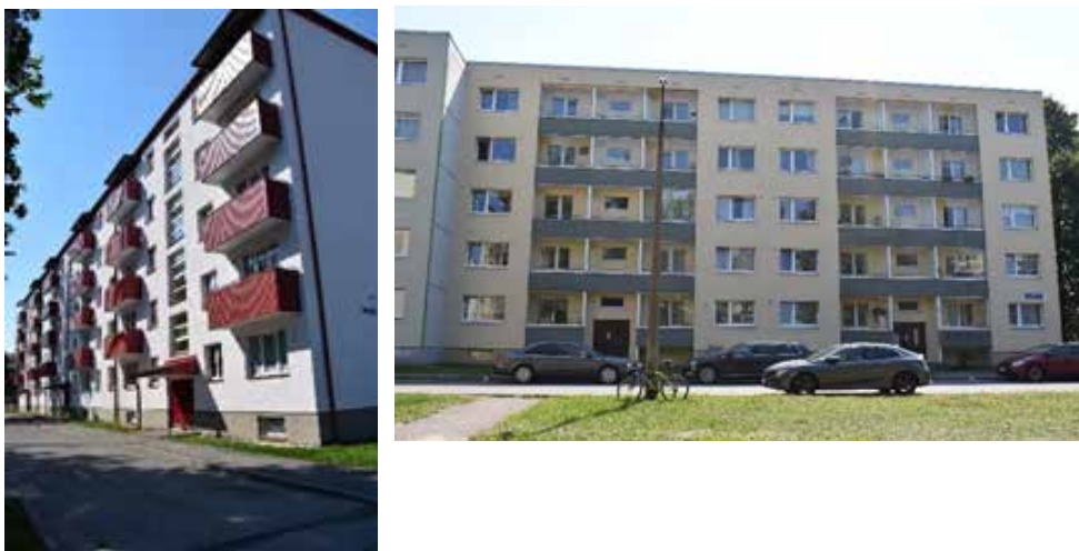
12. ábra Beüvegezett loggiák; Felújított erkélyek (saját fotók)
